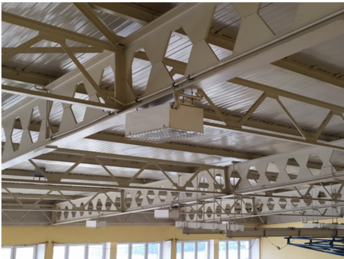
Fot. 10, 11, 12 Istniejące lampy i klimatyzatory.
