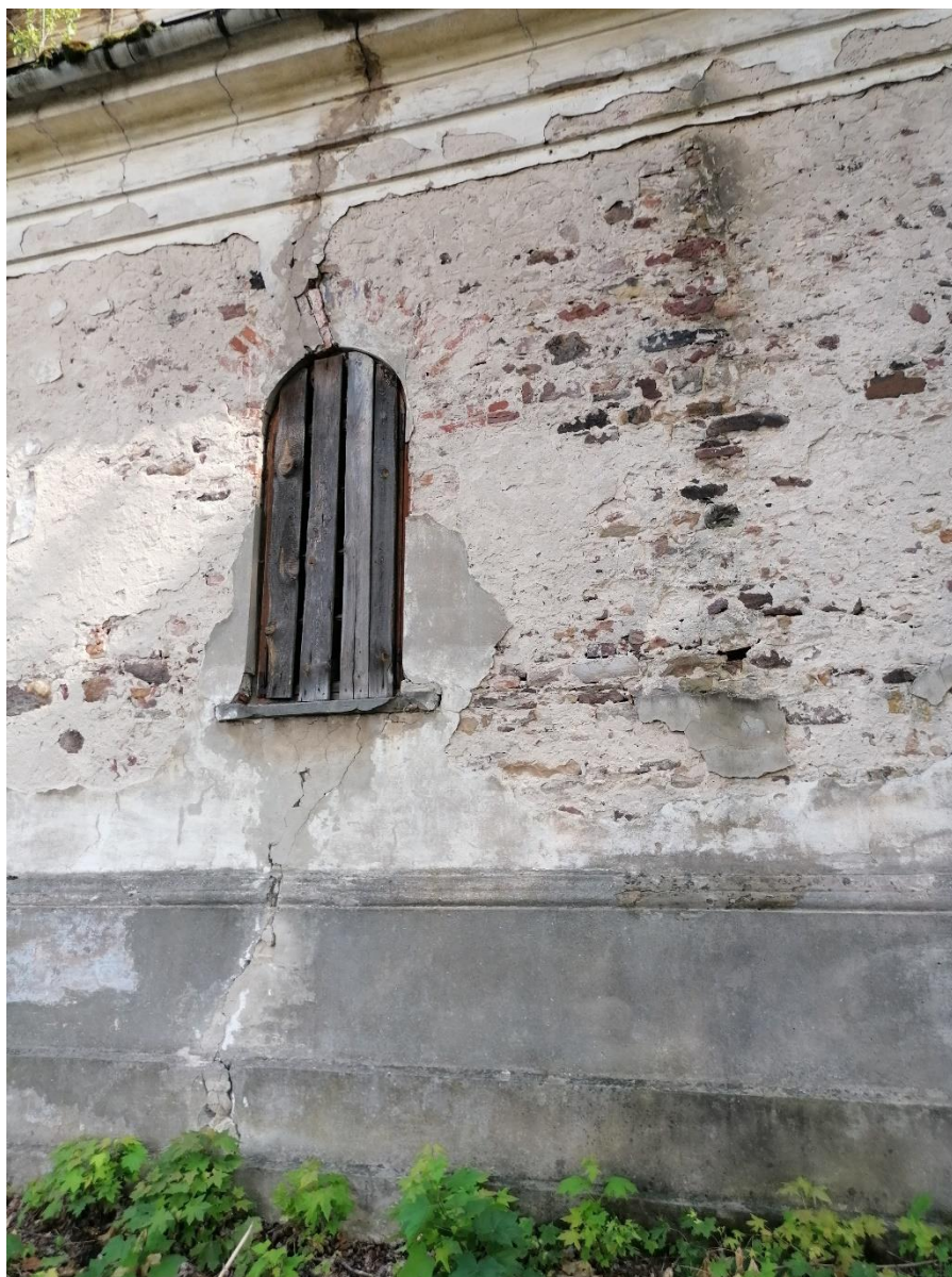
Zdj.2 Zarysowanie od fundamentów po gzyms
