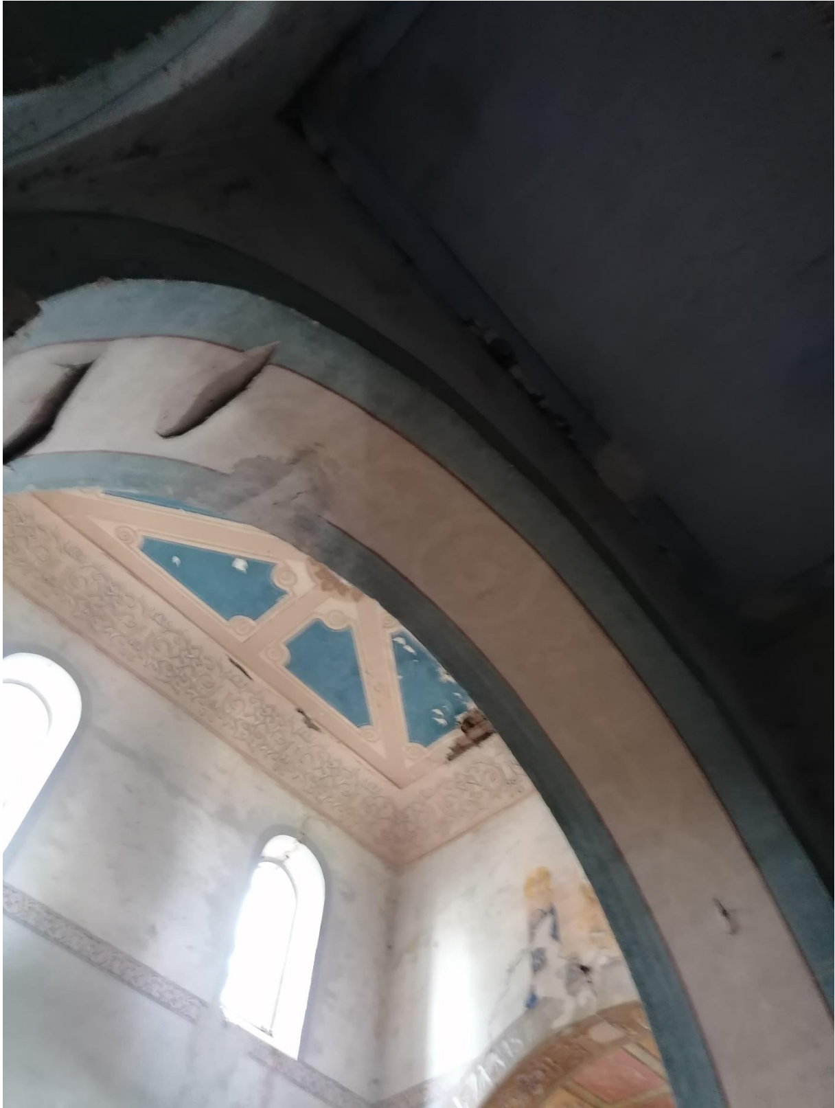
Zdj.19 Odspajająca się powłoka malarska
