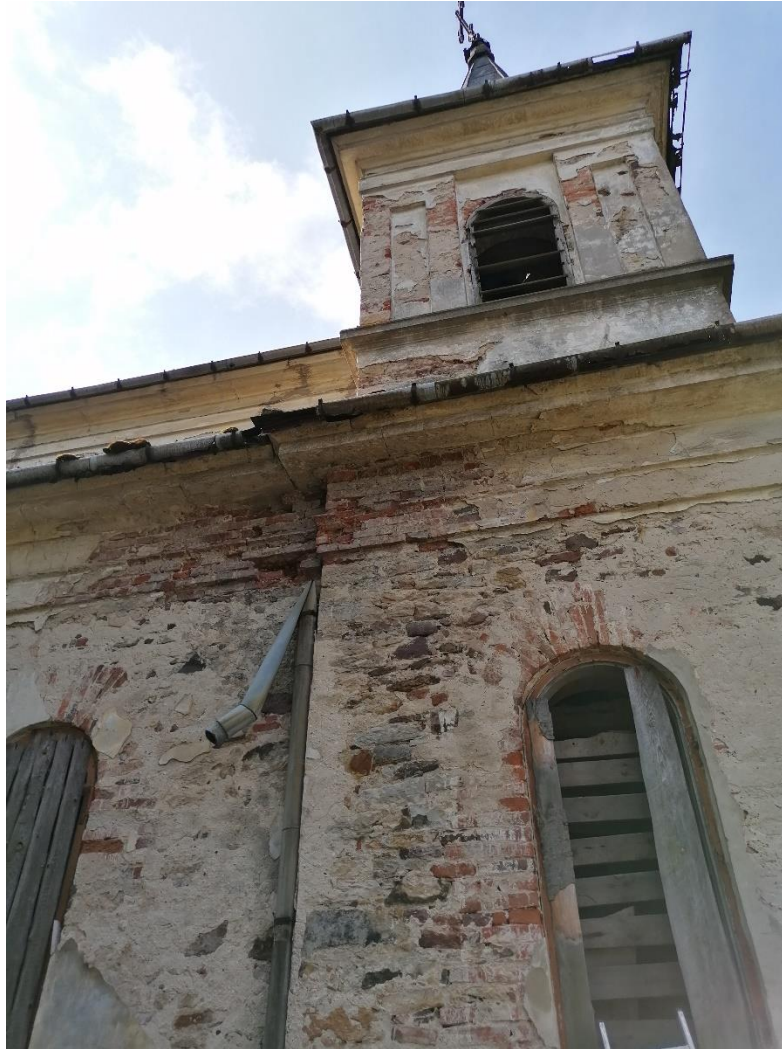
Zdj.12 Oberwana rura spustowa
