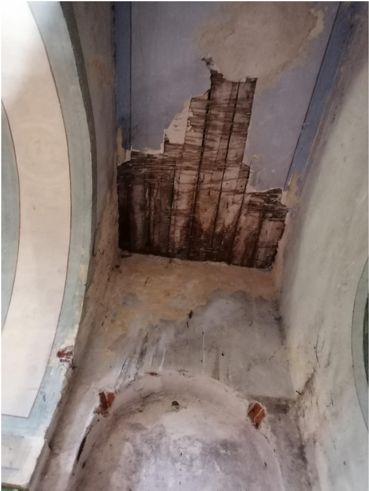
Zdj.18 Ubytek sufitu nawy bocznej
