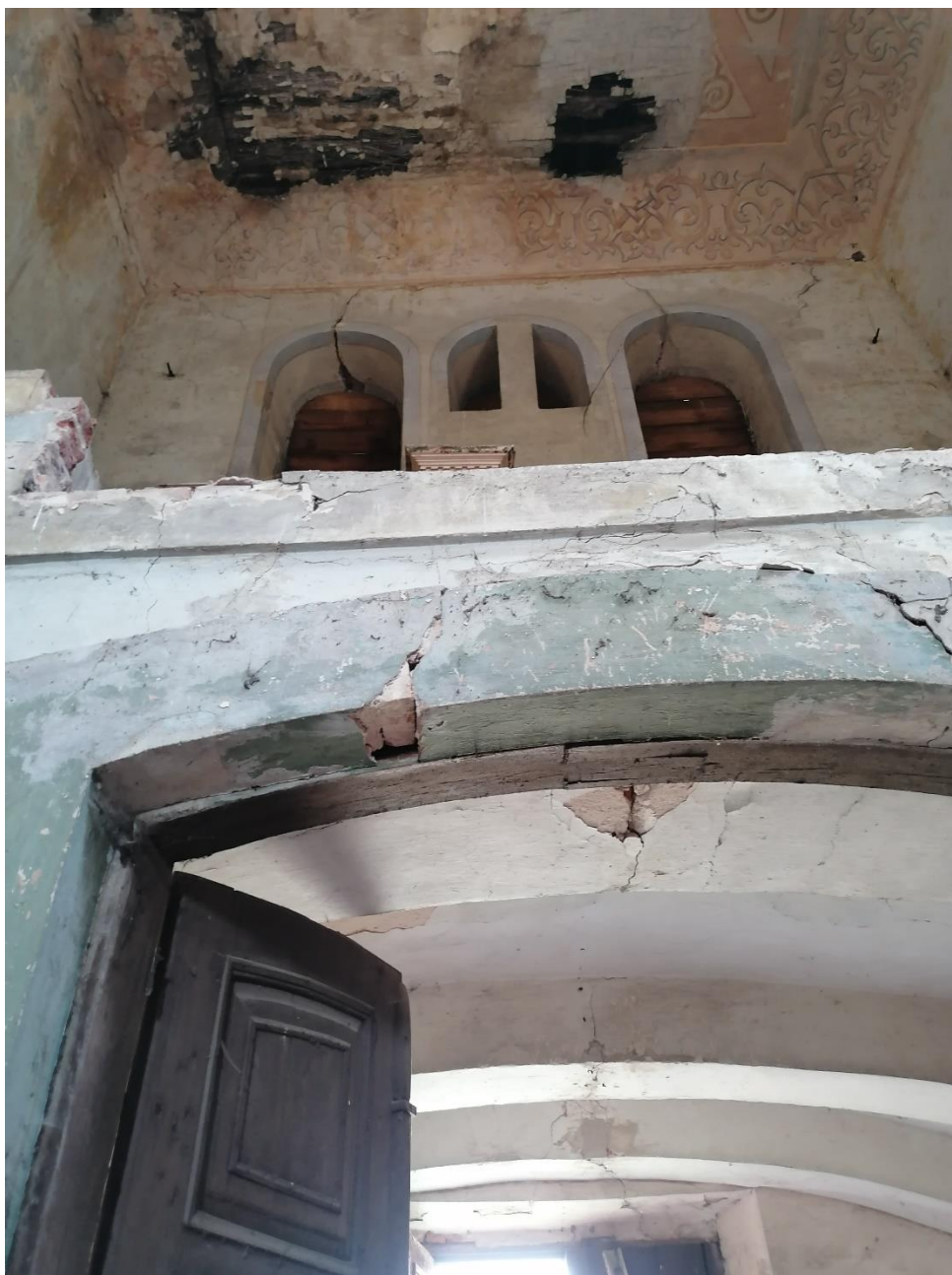
Zdj.8 Rysa nad drzwiami wejściowymi (u dołu) w schemacie „a”; wypadanie cegły z łuku (pośrodku); rysy nad oknami (nad chórem) w schemacie „a”
