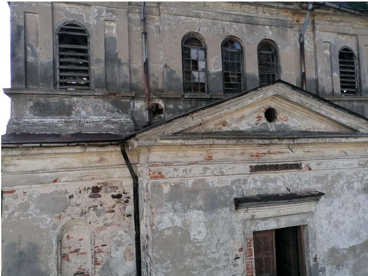
Zdj.5 Zarysowania ściany frontowej: pod oknem dzwonnicy (lewe górne), skośne rysy nad drzwiami w obu kierunkach aż do gzymśsu
