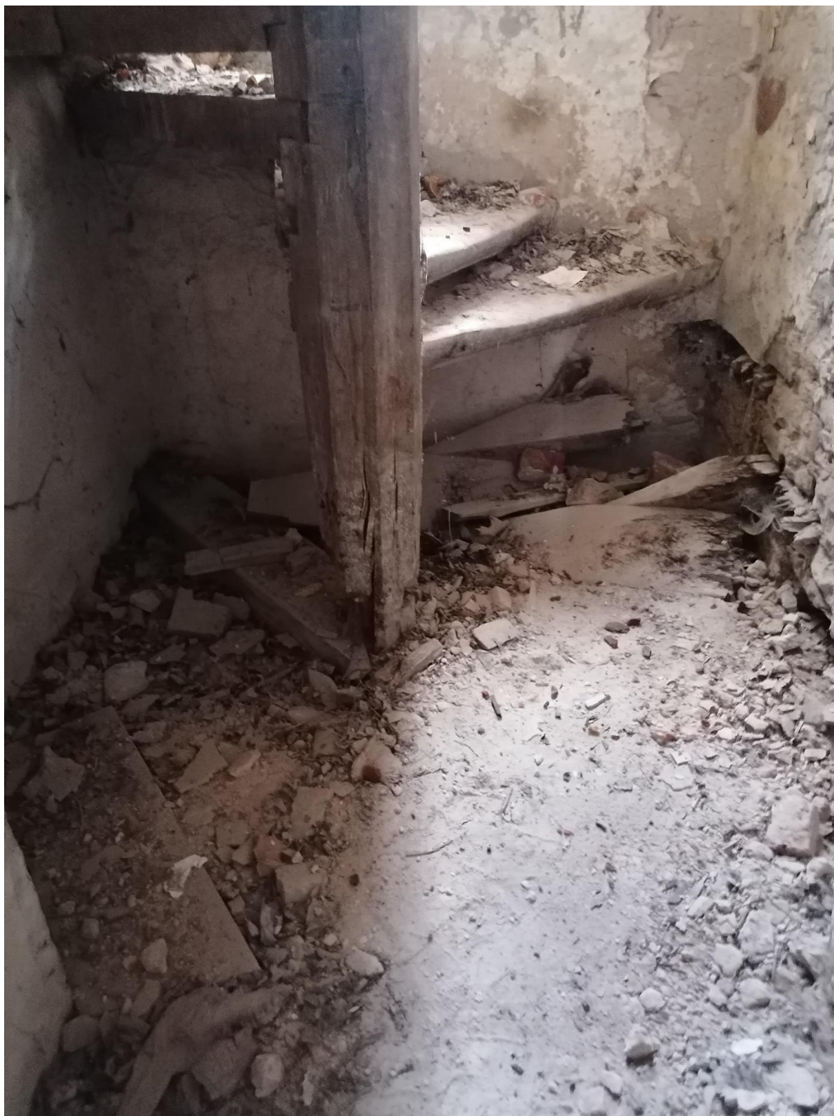
Zdj.35 Schody na chór. Skorodowana podstawa słupa
