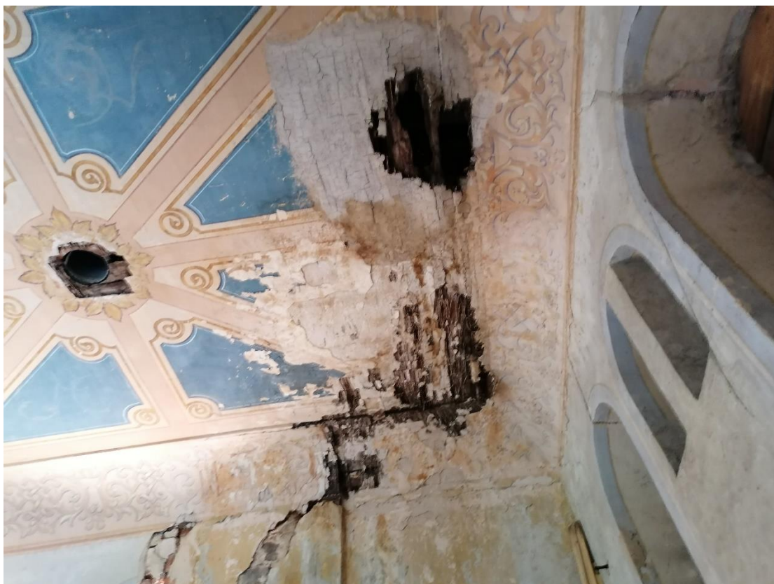
Zdj.14 Ubytek sufitu – nawa główna nad chórem
