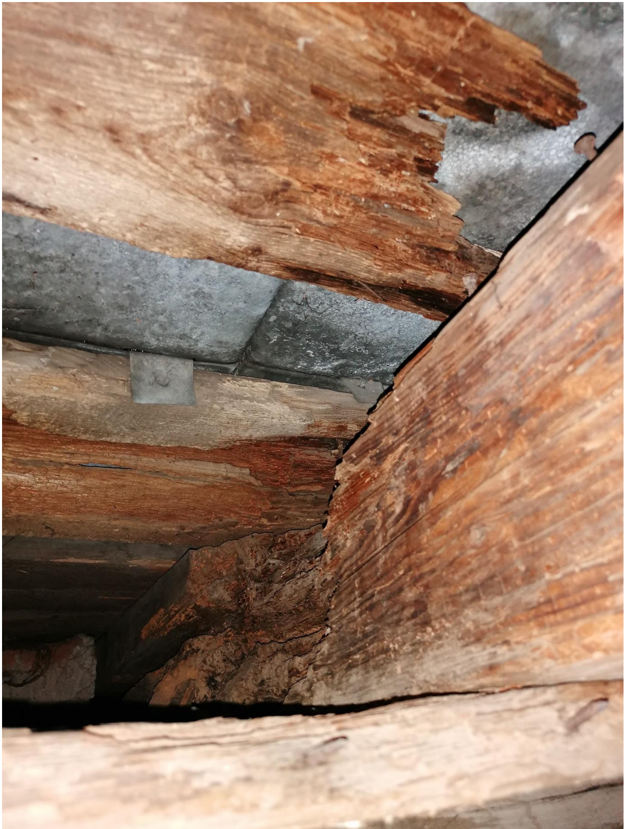
Zdj.32 Dach nad chórem. Spróchniała krokiew i deskowanie
