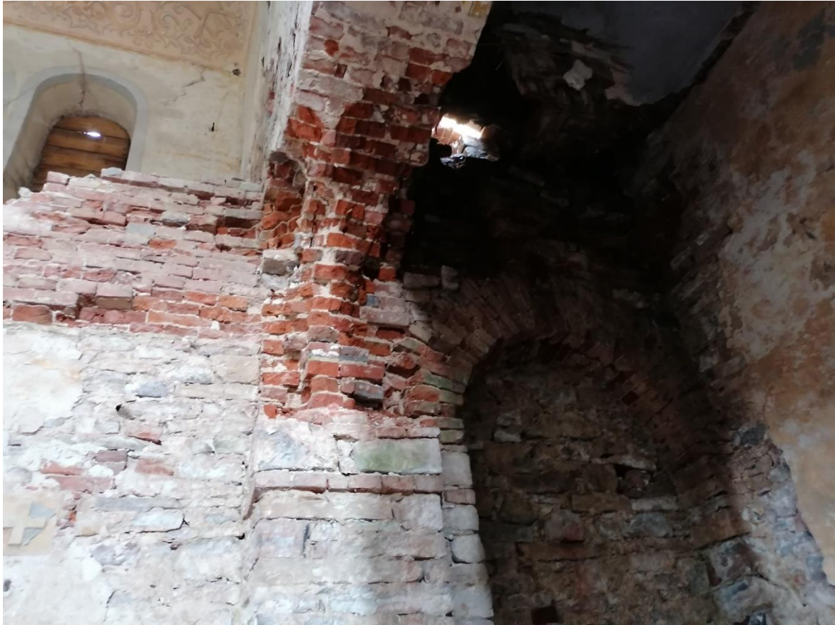
Zdj.11 Ubytek sklepienia nawy północnej. Widoczny otwór w dachu przez który latami wpływała woda.
