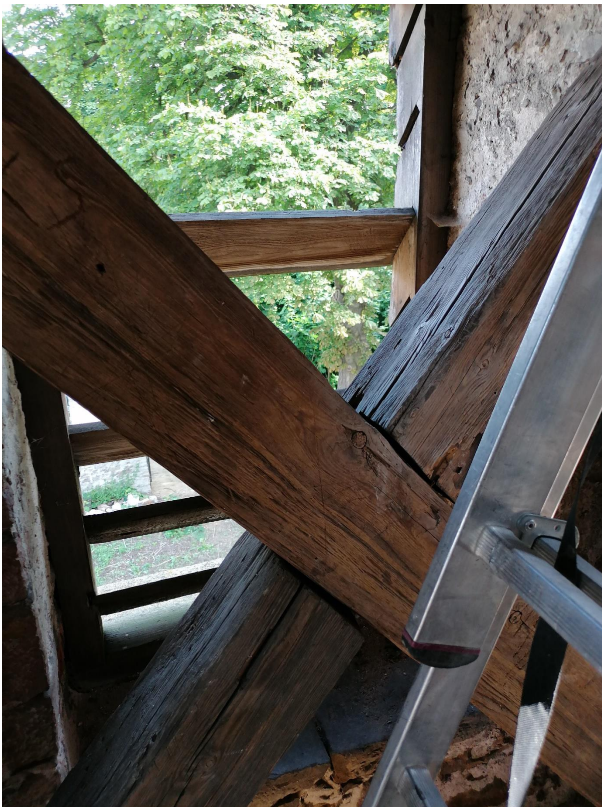
Zdj.31 Wieża frontowa. Luźne połączenia ciesielskie, drewno rozeschnięte.
