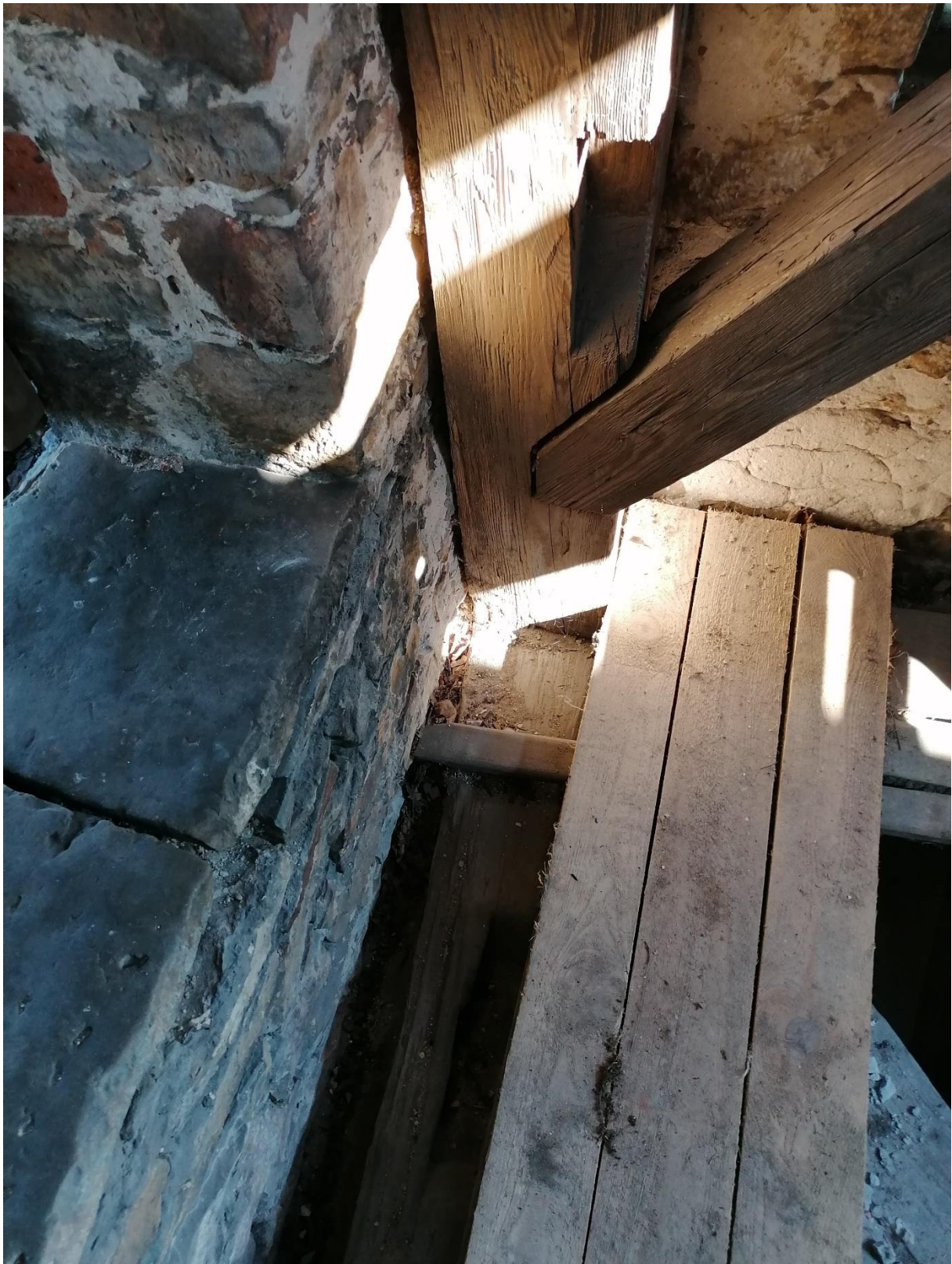
Zdj.30 Wieża frontowa. Brak elementu
