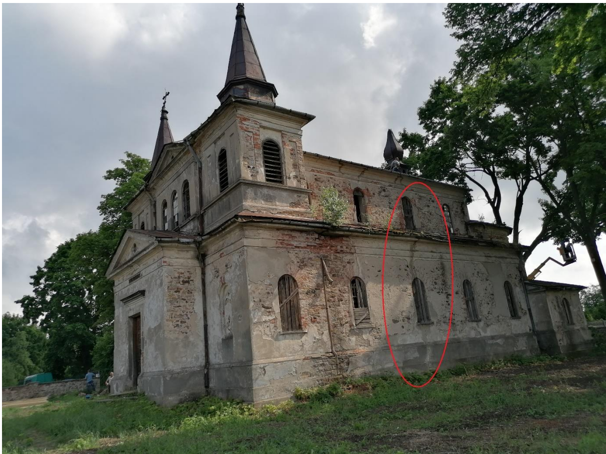
Zdj.1 Widok strony wschodniej z zaznaczoną rysą pionową.
