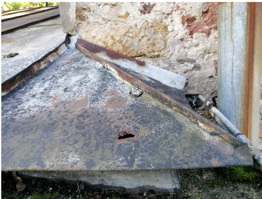
Zdj.25 Korozja i uszkodzenia blachy
