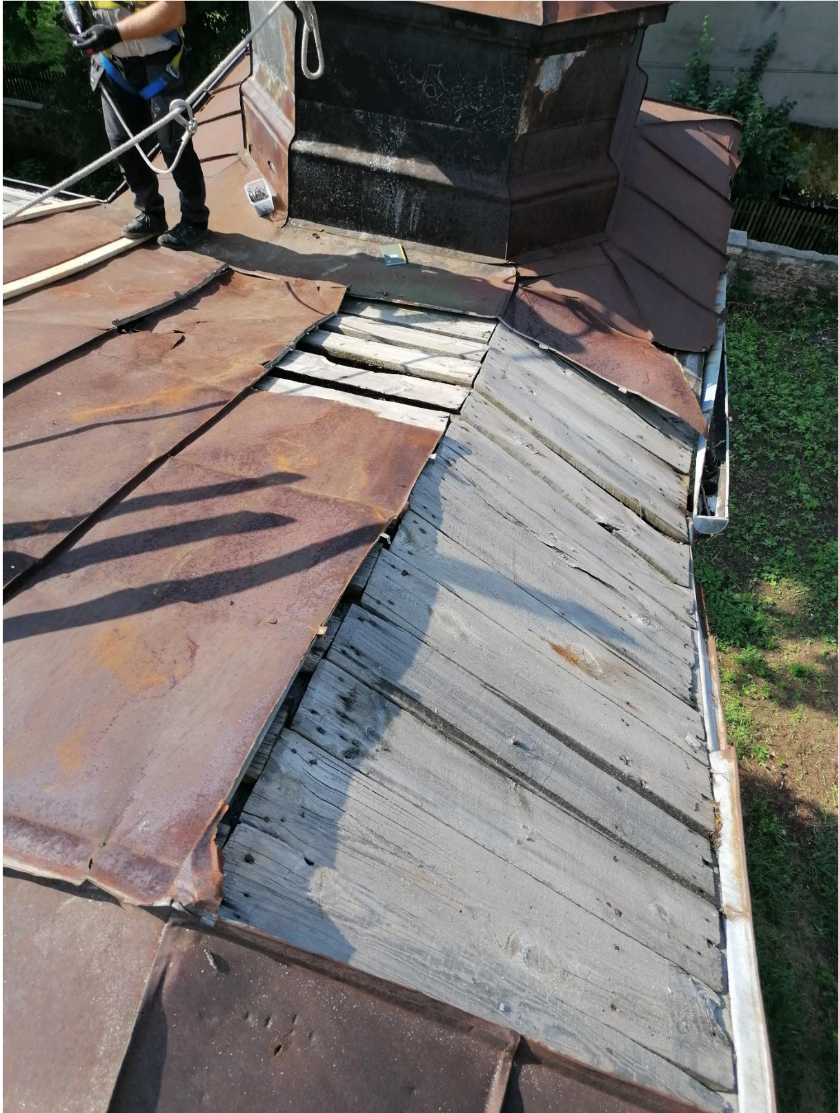
Zdj.22 Zerwana blacha od frontu, widoczne deskowanie
