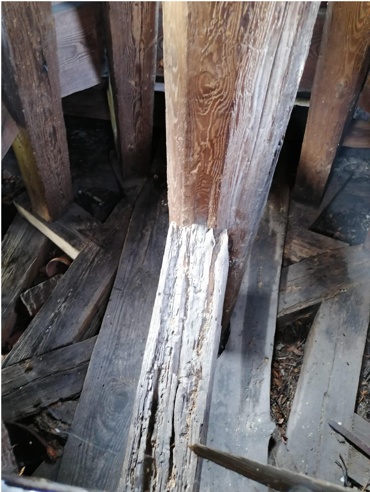
Zdj.27 Wieżyczka nad nawą główną. Wyraźna degradacja części elementów
