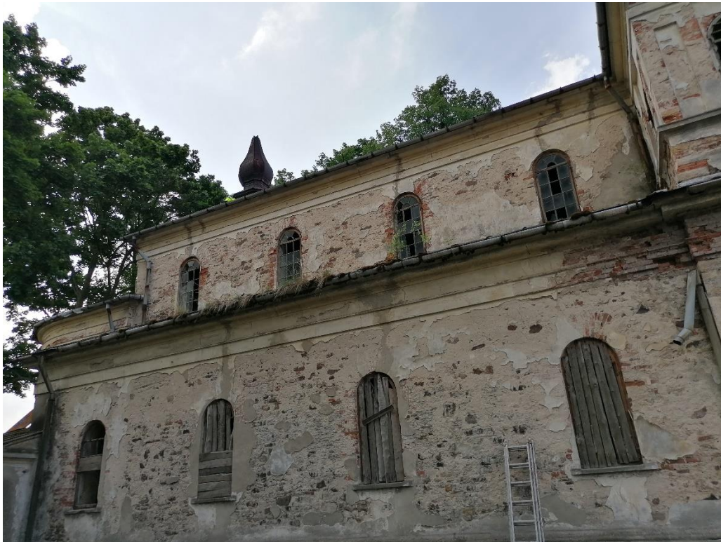
Zdj.10 Sklepienia okien zarysowane w schemacie „a”
