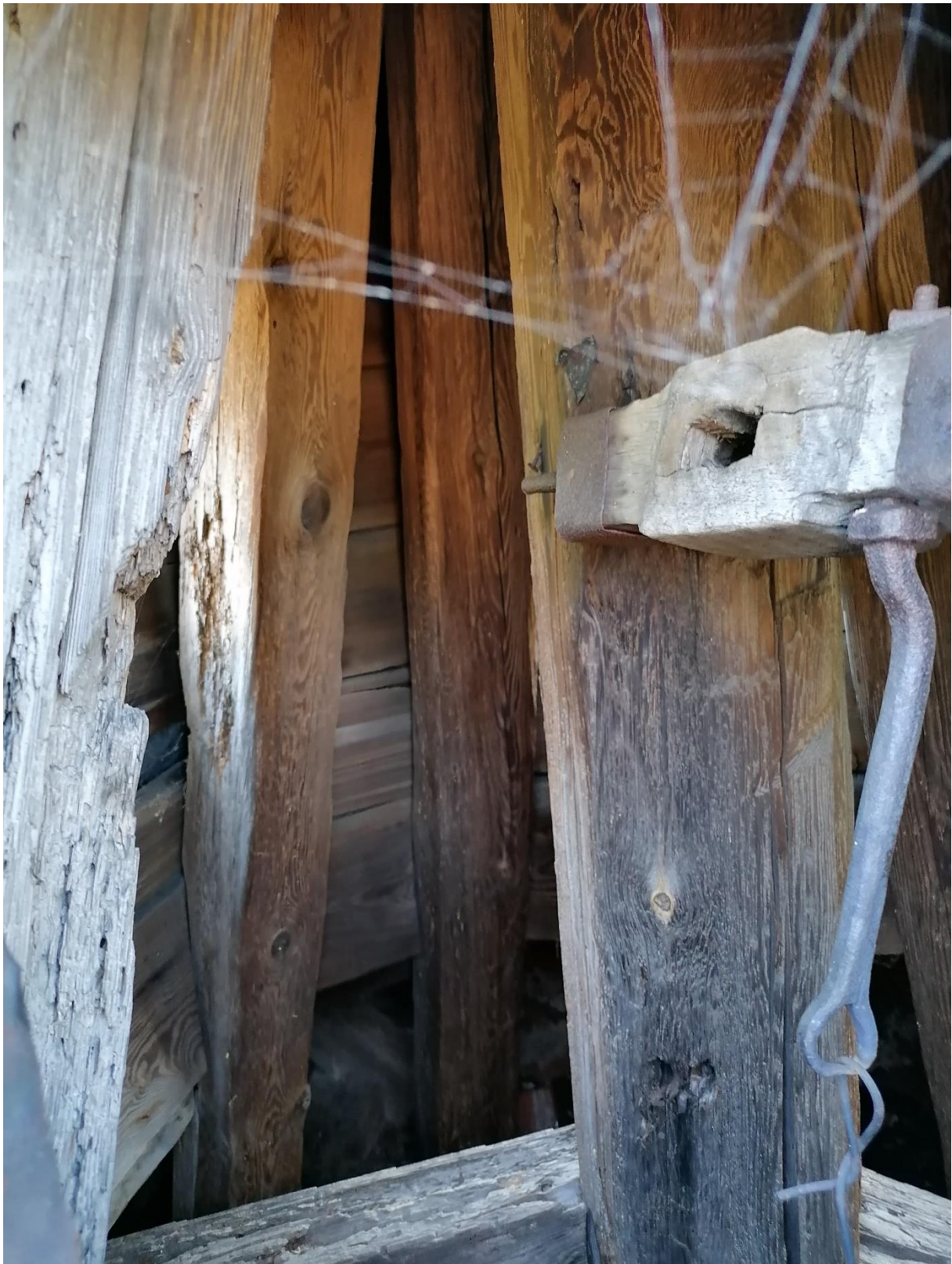
Zdj.28 Wieżyczka nad nawą główną. Wyraźna degradacja części elementów
