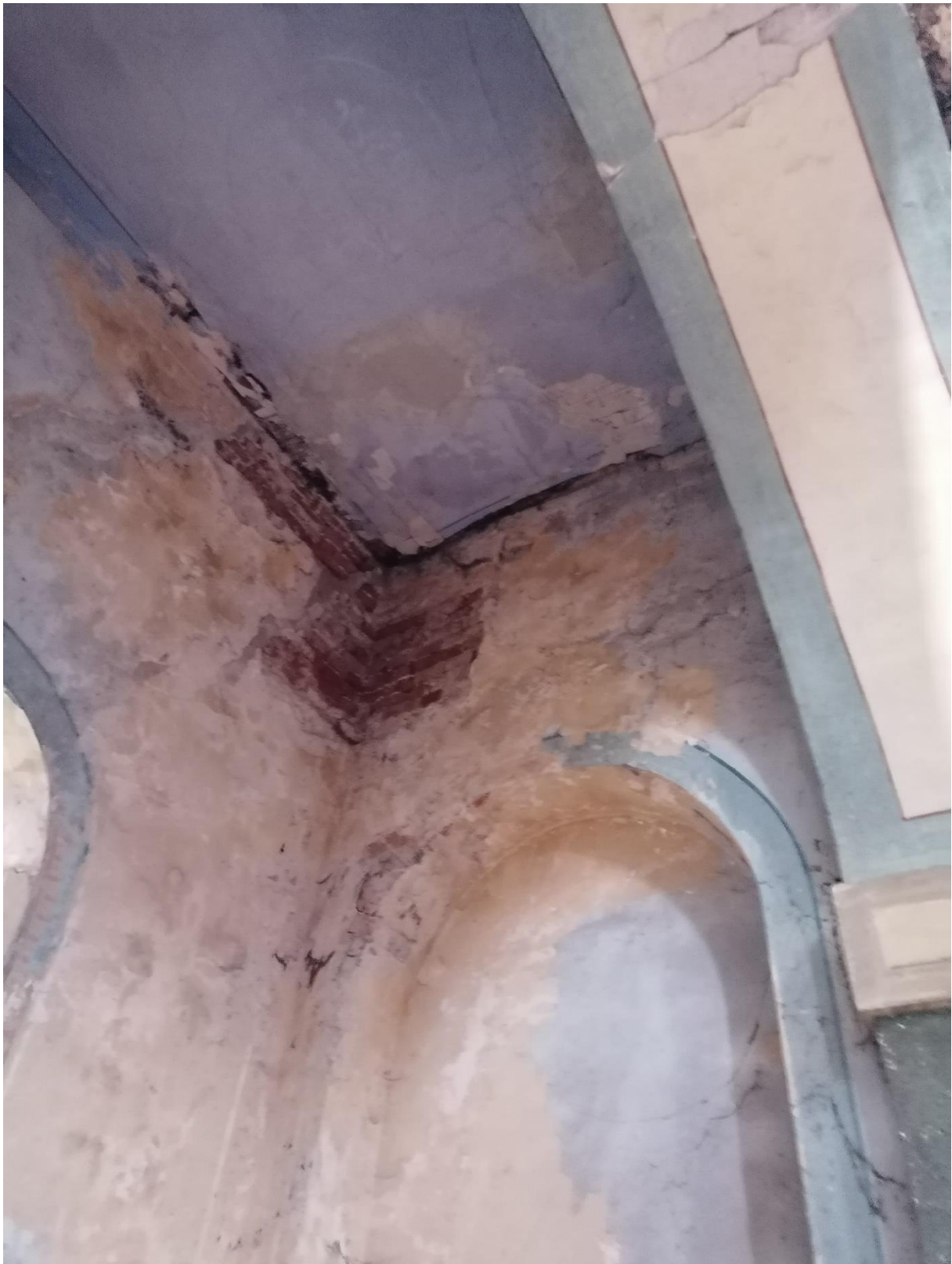
Zdj.20 Ubytek tynku ścian nawy bocznej
