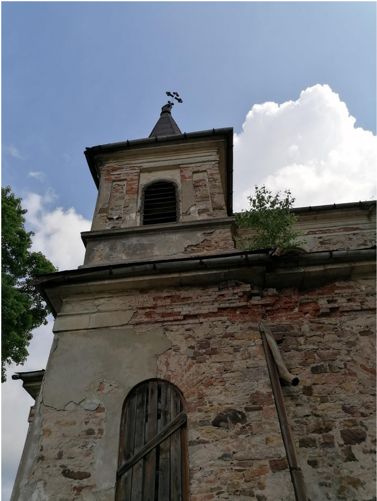
Zdj.6 wyrwa w murze po stronie południowej, odspojony tynk pokazuje konstrukcję gzymsu.
