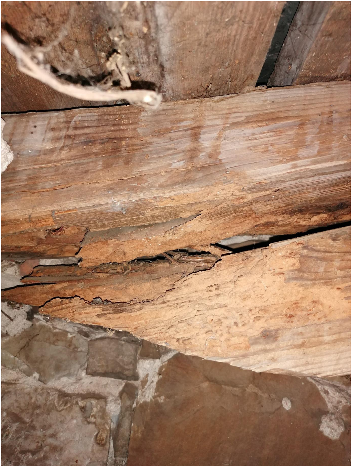
Zdj.33 Dach nad chórem. Spróchniała i złamana krokiew
